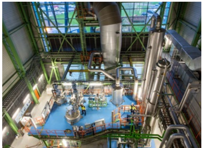
مصنع تجريبي لاحتجاز ثاني أكسيد الكربون واستخدامه في منشأة Twence لتحويل النفايات إلى طاقة. الصورة مهداة من Twence.
